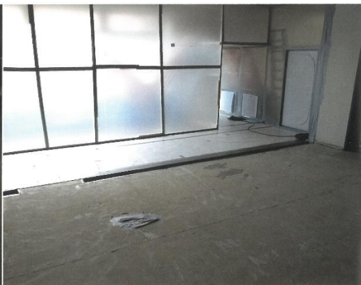
Gereinigter Schwarzbereich nach Rückbau einer Leichtbauwand mit asbesthaltigen Spachtelmassen und Entfernung des asbesthaltigen Bodenbelags.
